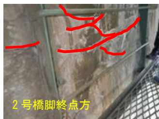
写真1 桁座のひび割れ
