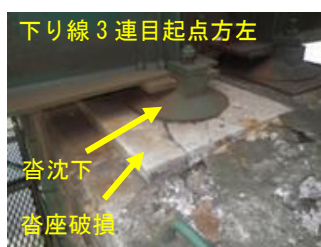
写真2 沓座および桁座の変状
