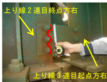
写真3 破断した連結工
