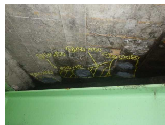
写真-3.2 損傷状況
