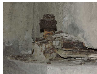
写真-4.4 機能障害一例
