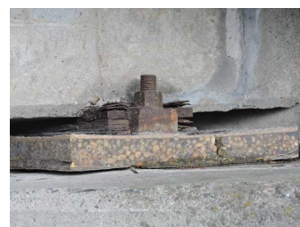
写真-4.2 沓座反張り
