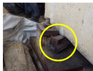
写真-2 変状発生箇所
