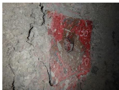
写真-1 ベアリングプレートの変形状況
