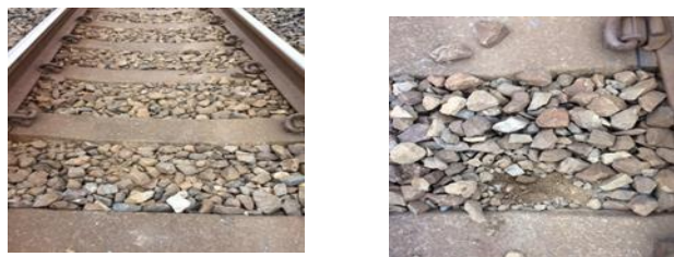
図-5 道床交換施工箇所の土砂混入状況
