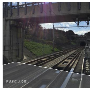
図-2 凍上発生箇所
