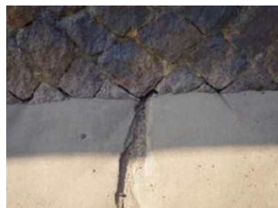
図 5 根固め工下部の伏流水の状況
