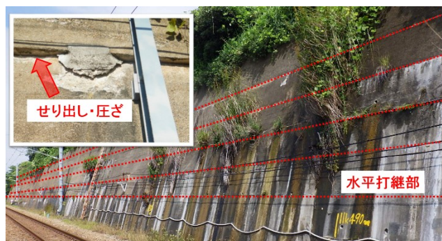
写真-1 土留壁の変状
