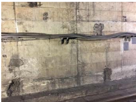
写真－1 インタビュー使用写真（鉄筋露出）
