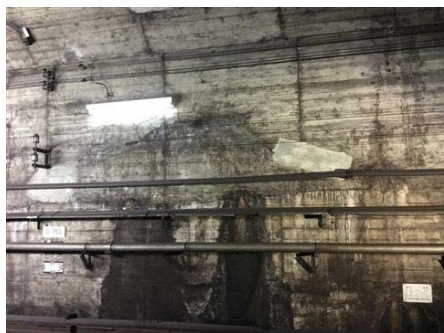
写真－2 インタビュー使用写真（漏水）
