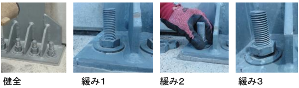
図－1 支柱下端におけるボルト緩みの再現状況
