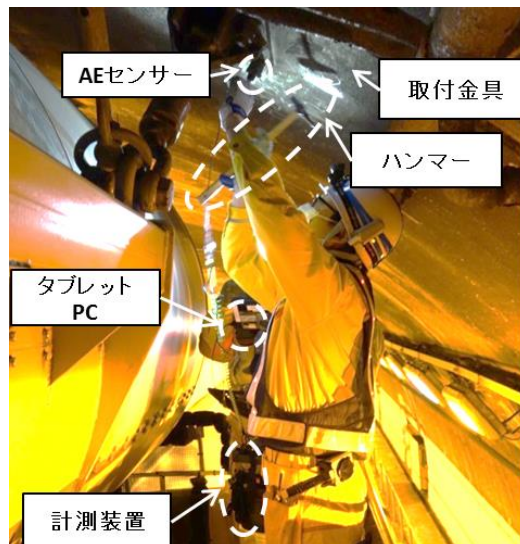
図1 AE センサを用いた打音検査装置
