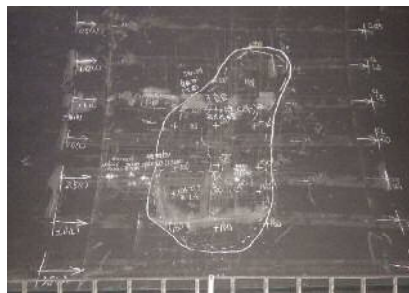
写真-1 濁音箇所状況
