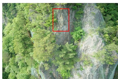
図－4 岩塊の抜け落ち跡
