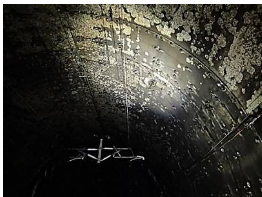
写真-2 覆工コンクリート表面の爆裂
