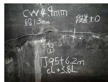
写真-1 覆工ひび割れ状況
