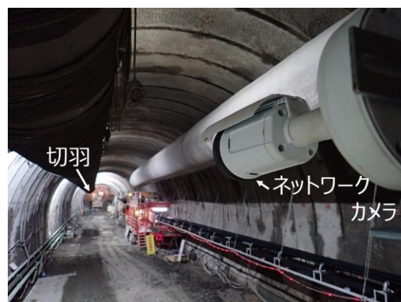
図-3 ネットワークカメラ設置の様子
