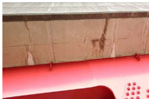
写真-2 損傷写真
