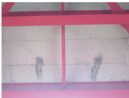
写真-2 ひび割れ、漏水・遊離石灰
