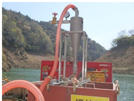
写真-2 サイクロンフィルタ(前処理)
