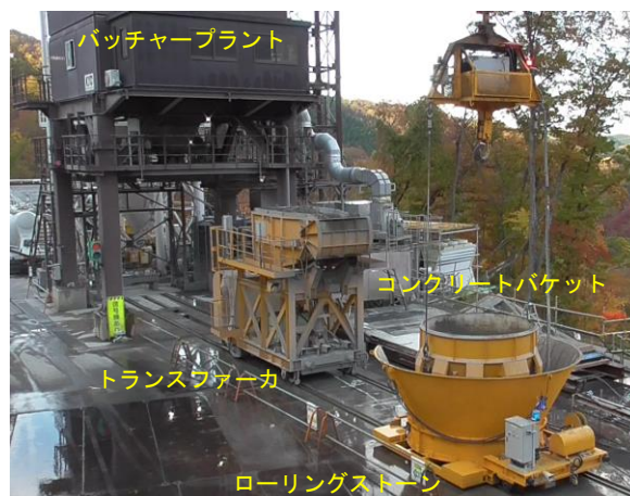
図-3 ダムコンクリート運搬・打設設備
