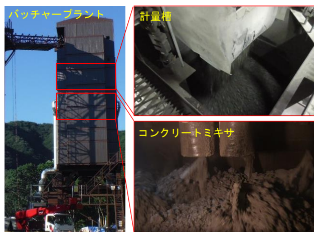
図-2 コンクリート製造設備
