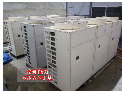
写真-1 チラー設備
