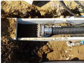
写真-6 ノズル先端状況
