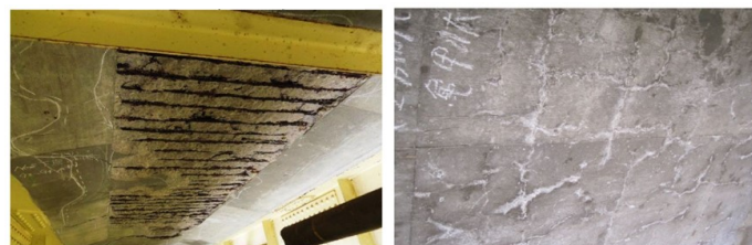
写真-1 既設床版（下面）の劣化状況
