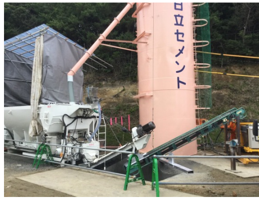
写真-2 地上部設備
