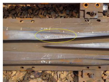
図 1 マンガンクロッシングの挫壊傷
