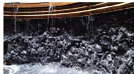
写真-1 支持層付近湧水状況
