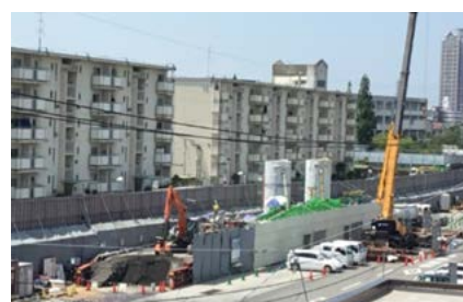
写真-2 HGS製造プラント
