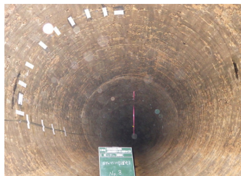
写真 1 自動計測状況
