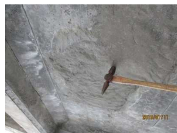
写真-8 床版下面モニタリング
