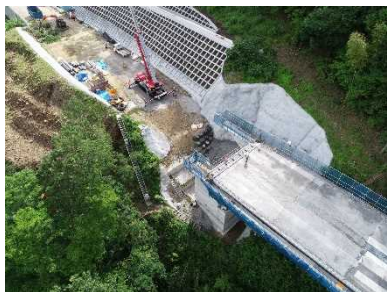
写真-1 橋台周辺の余掘り
