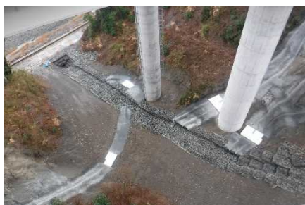
写真-4 油水分離枡集約状況
