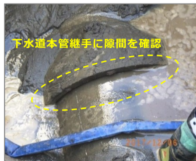
図-4 空洞原因事例：下水道本管継手部のわずかな隙間
