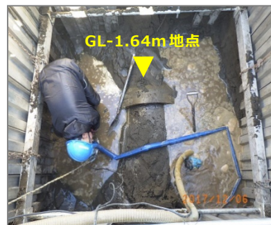
図-3 空洞原因調査状況
