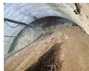
写真-1.切羽の崩落状況
