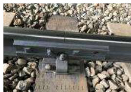
写真-2 継目板ボルト脱落再現
