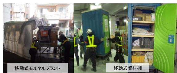
写真1 移動式プラント・資材棚
