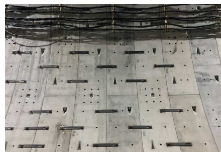
写真-1 目開き防止プレート
