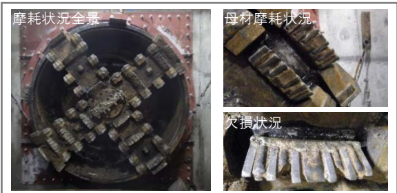
写真-1 カッタービット摩耗状況
