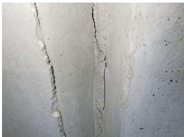
写真-2 『不良』判定の例
