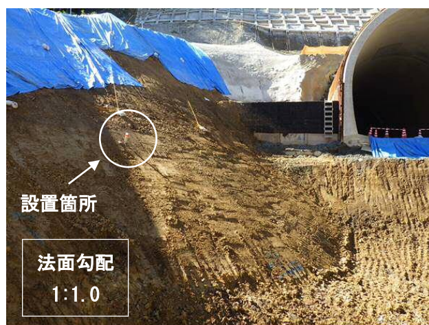
写真-1 装置設置状況
