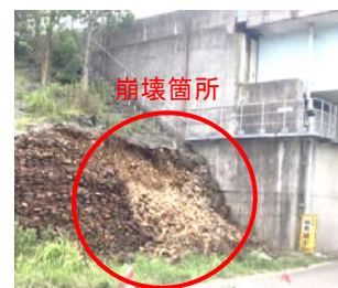
図-1 ふとんかご崩壊状況 (上り線側)
