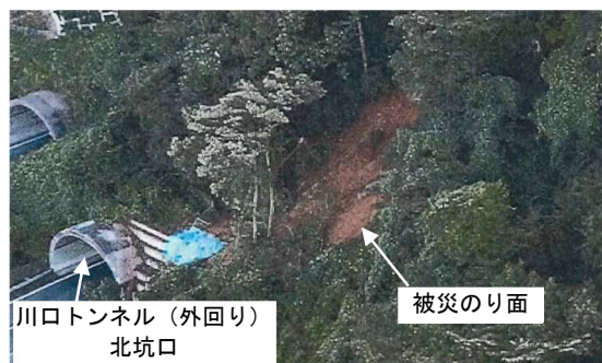
写真-1 トンネル坑口付近災害状況
