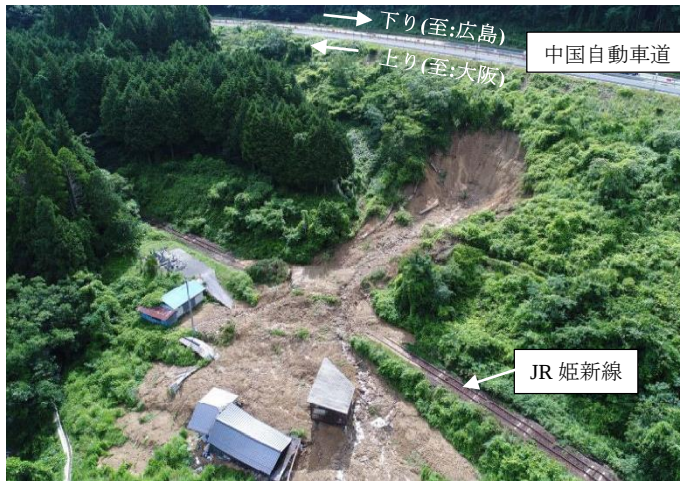
写真-1 盛土のり面被災状況
