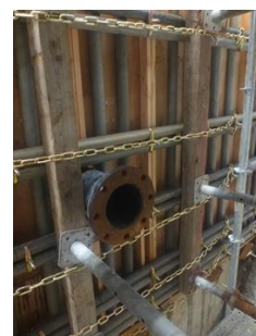
写真-1 配管状況
