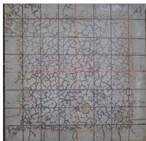
図-4 加熱面の損傷状況 (LH)
