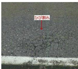
写真-1 ひび割れ
