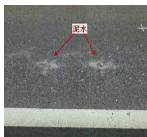
写真-2 噴出した泥水
