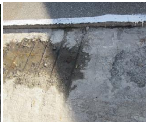
写真-8 露出した鉄筋
