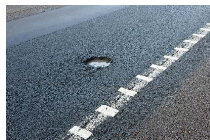
写真1. ポットホール発生状況
