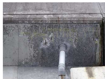
写真-1 変状箇所(鉄筋露出・スケーリング)
