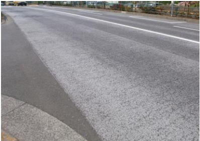
写真-1 塗料の剥れ
