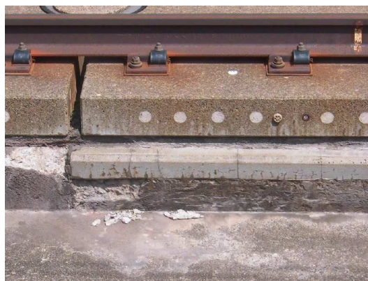
図-4 再劣化状況
