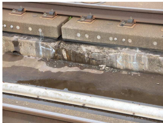
図-3 劣化状況写真
