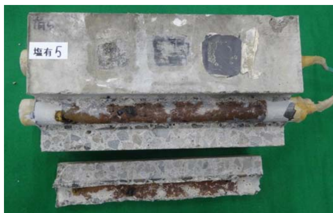
図5 鉄筋の腐食状況(塩有)
