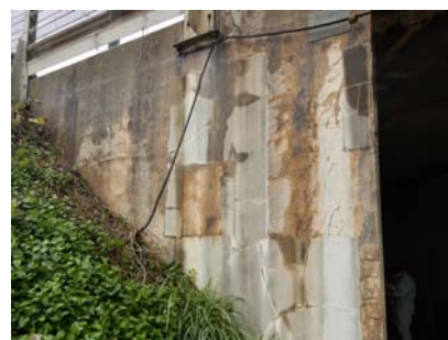
写真-2 ASRによる再劣化状況
