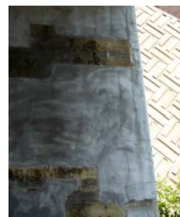
写真-3 断面修復材再劣化状況
