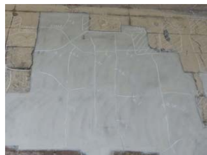
写真-1 塩害による再劣化状況
